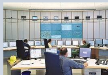
発電所監視制御
